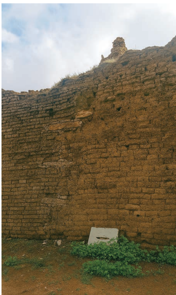
Imagen 15. Acercamiento de los remiendos en la parte central de la barda perimetral. Fotografía: Roberto Carrillo Acosta, noviembre de 2023.
