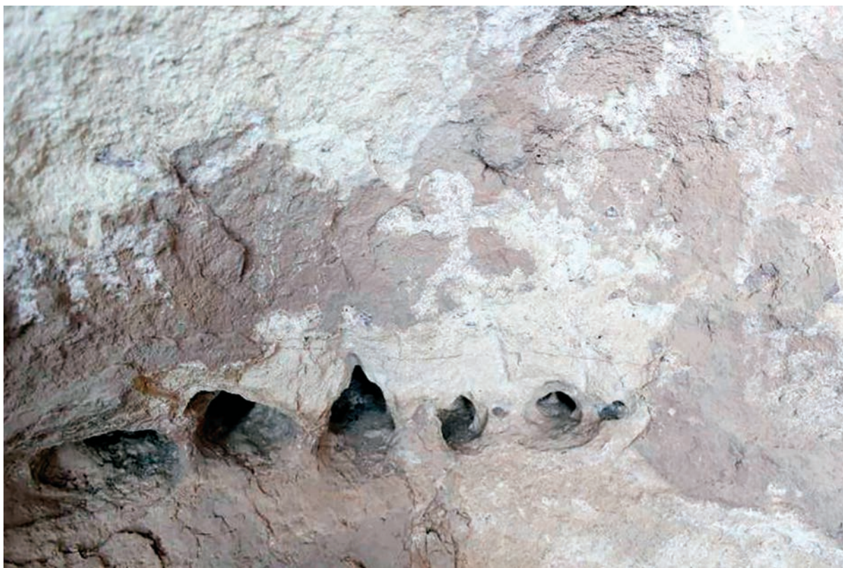
Imagen 4. Deterioro por erosión eólica y pérdida de soporte pétreo en el área con pinturas rupestres.
